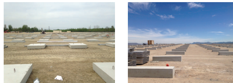
Longrines béton (crédit photo : Urbasolar)
