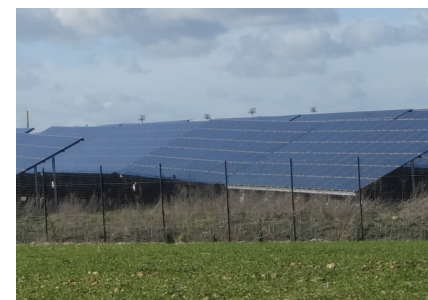
Centrale TIPER Solaire 2 en exploitation (crédit photo : Urbasolar)
